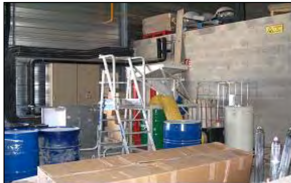
Photo 5 - Poste de cassage manuel des enveloppes des lampes à décharge
