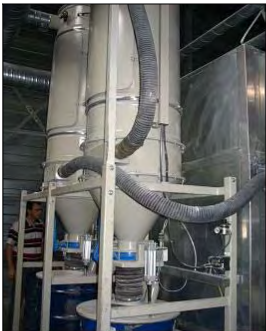
Photo 1 - Colonnes de récupération des poudres fluorescentes
